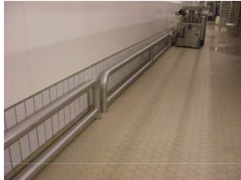
Abnehmbarer Rammschutz im Fahrbereich; sauberer, gut zu reinigender Boden; (System hier: Cerunert)
