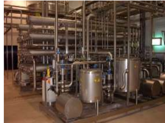
Beispielhafte Installation einer RO-Anlage: rundum gute Zugänglichkeit für Reinigung und Wartung
