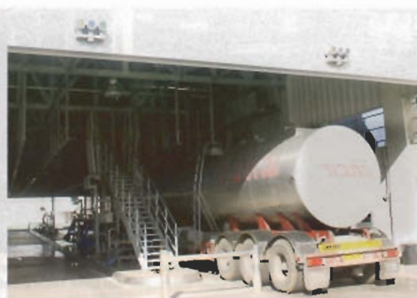
Die Tankzüge werden über eine Signalanlage an die richtige Annahmelinie geführt
