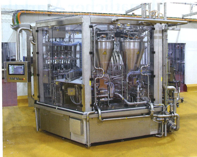
Für die dritte Kerrygold Extra Linie hat Ornua einen weiteren Rundläufer von Waldner (Dosomat 16.4) installiert (Foto: Ornua)
